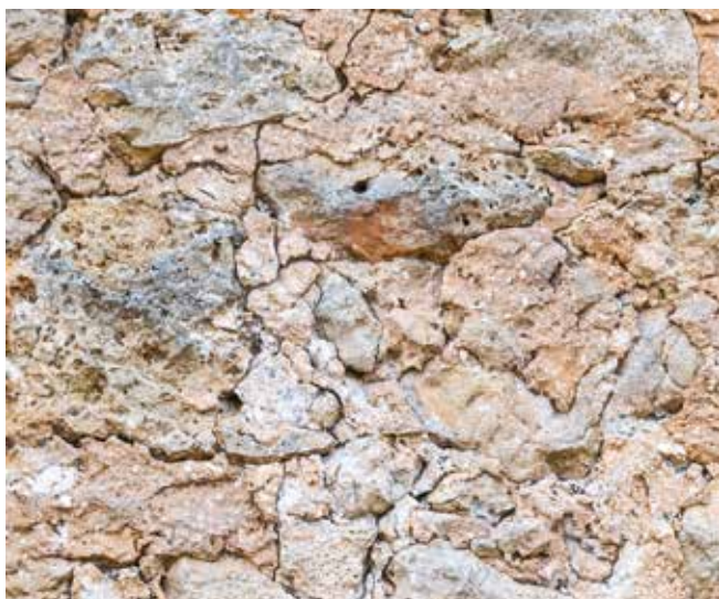
Texture d'un enduit ancien de rejointolement sur mur en dolomie.
