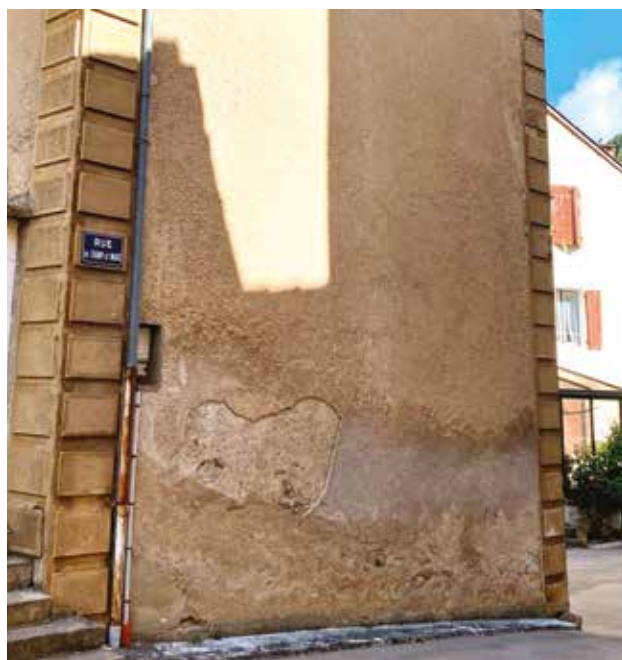
Effets des remontées capillaires sur le bas des murs.
